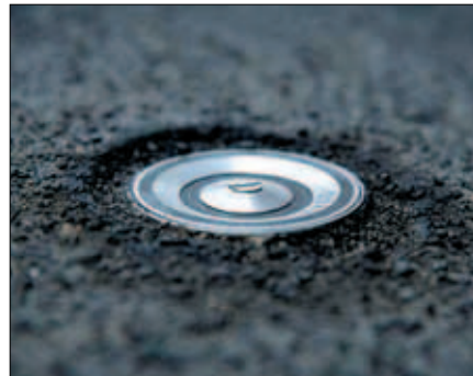
Die beiden Feuchte- bzw. Temperaturfühler sind in nicht überdachten Bereichen ebenerdig und in waagerechter Position montiert.
