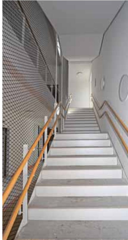
Kindgerechte Schutznetze sichern den Treppbereich.
