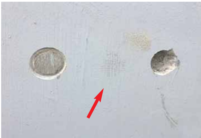
Abbildung 7: Ansicht einer Prüfstelle mit Abreißversuchen und Gitterschnittmethode (siehe roter Pfeil)
