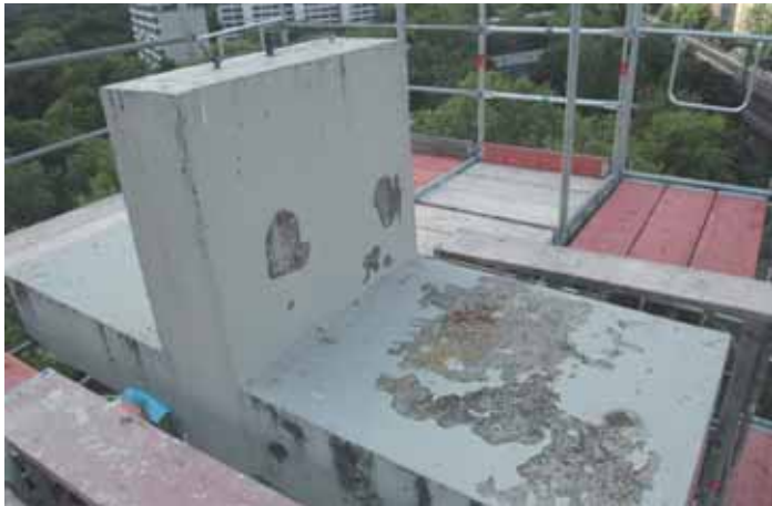
Abbildung 5: Schäden auf der Oberseite des Kreuzes
