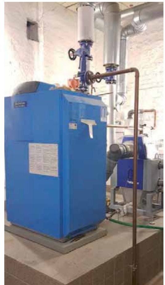
Bild 2: Ein Brennwertkessel mit Brennwerttuning
