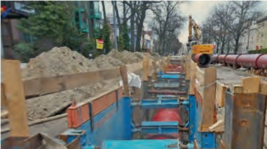
Bild 9: Neue Abwasserdruckrohrleitung DN 1200 GGG und rechts Interimsleitung DN 1000 GGG.
