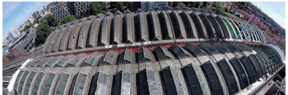
Blick von oben auf die Gleishallendächer mit dem bereits teilweise geöffneten Dach und der Schutzbrücke (August 2022)
