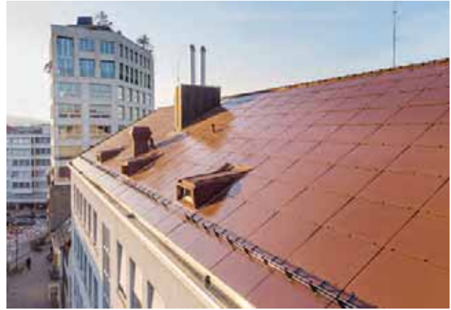
Abb. 14: Bauwerksintegrierte Photovoltaik in Zürich: Solarmodule mit integriertem farbigen Film
