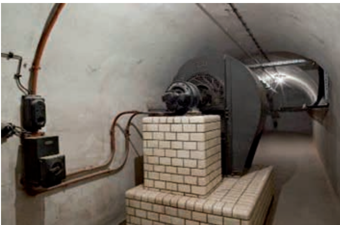
Im Untergeschoss ist noch ein Teil der historischen Lüftungsanlage – hier einer der Ventilatoren – erhalten, die jedoch nicht mehr in Betrieb ist.
