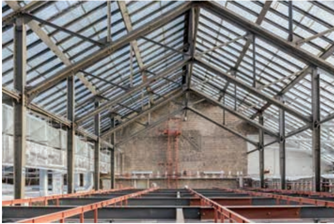
Das Bestandsglasdach des Pergamonmuseums weist erhebliche Beschädigungen und Undichtigkeiten auf.
