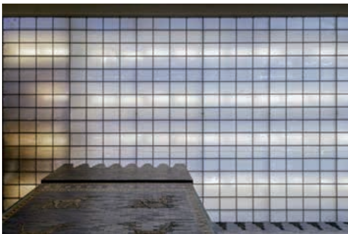
Zahlreiche Glasscheiben der Lichtdecke – hier oberhalb des Ischtartors – sind defekt oder stark verschmutzt. Dies beeinträchtigt die natürliche Beleuchtung der Ausstellungsobjekte. Netze verhindern, dass sich lösende Scheiben herunterfallen.
