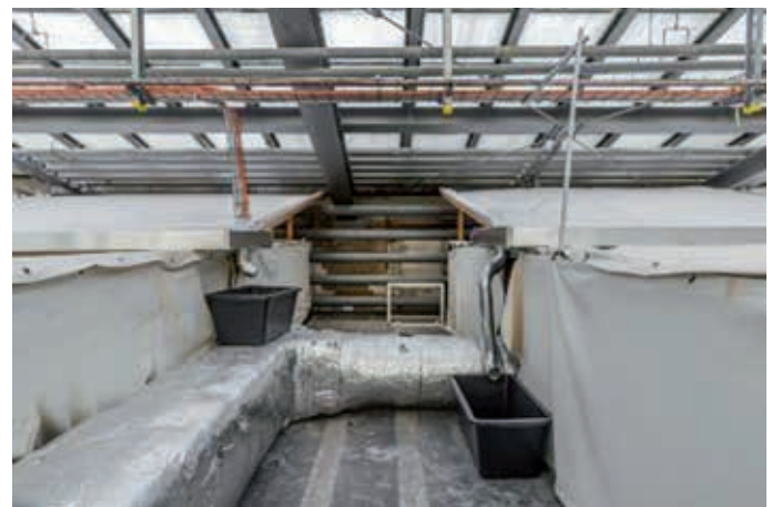
Das historische Dach des Pergamonmuseums ist an vielen Stellen undicht. Um zu verhindern, dass eintretendes Wasser bis in die Ausstellungsbereiche gelangt, wurden behelfsmäßig Auffangwannen aufgestellt und Planen eingezogen.
