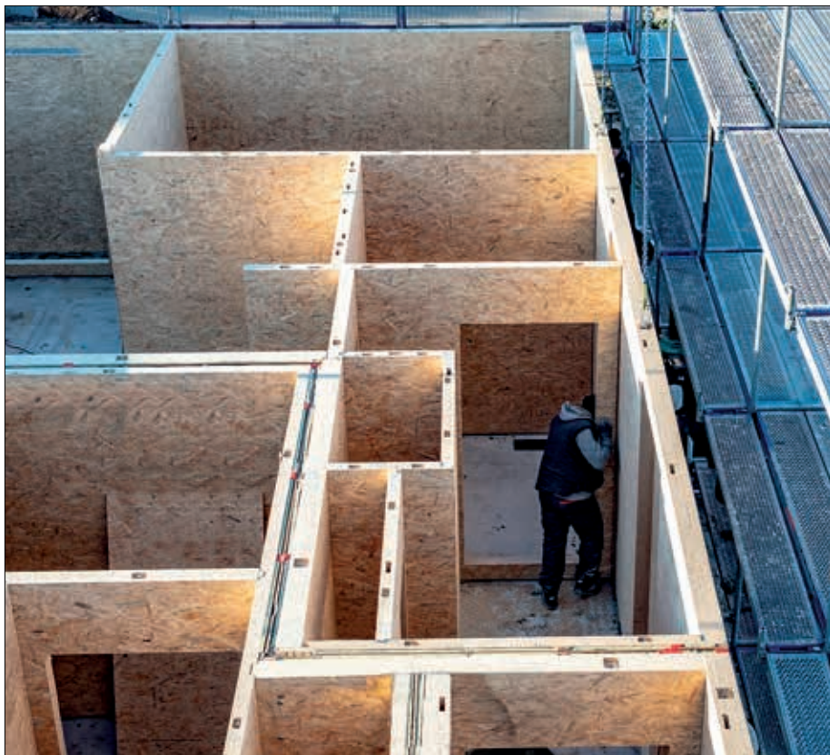
Verarbeitete ONE-BLOCK Wohnungstrennwand zwischen zwei Wohnungen (Bildnachweis: SWISS KRONO | Foto: Michael Weithe)
