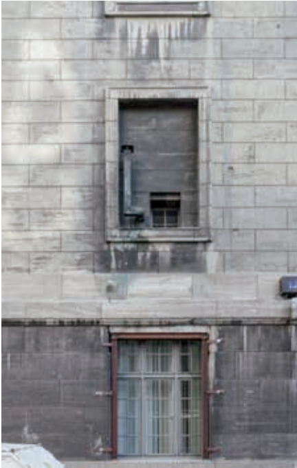
Einzelne Fensterstürze sind so stark beschädigt, dass Stahlstützkonstruktionen eingebaut werden mussten.
