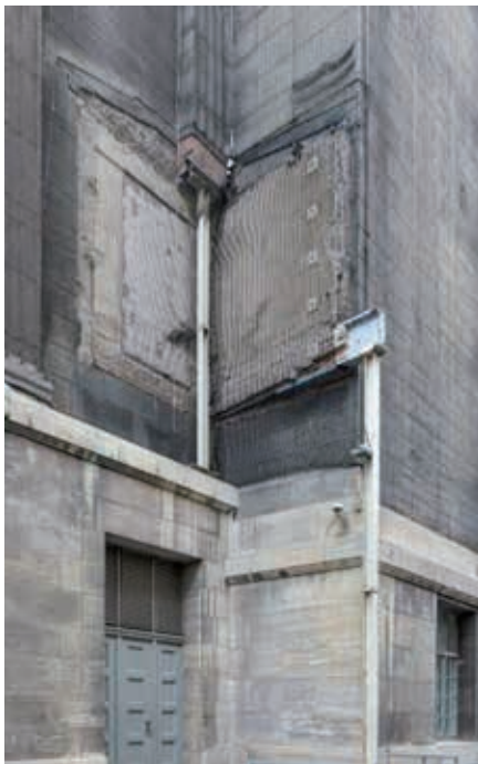
Unzählige Mängel, wie hier vormals provisorisch geschlossene Öffnungen in der Außenhaut des Gebäudes, müssen im Rahmen der Grundinstandsetzung aufwendig behoben werden.
