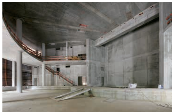
Der untere Teil des Gasometers (hier in der Rohbauphase) wird wieder zum Konferenzbereich und damit zum Forum des EUREF-Campus.
