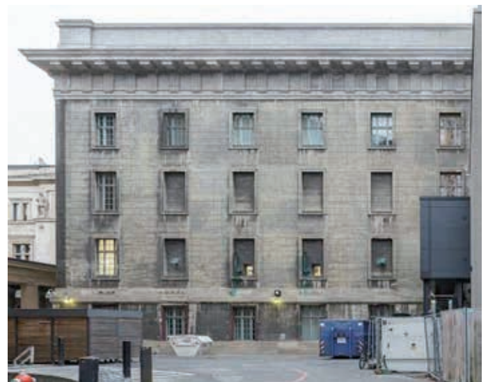
Die Fassade des Pergamonmuseums weist erhebliche Schäden auf, unter anderem starke Verschmutzungen, Risse im Naturstein und Kriegsschäden wie Einschusslöcher.
