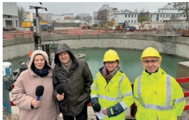
Das Regenwasserspeicherbecken in Berlin-Mitte.
