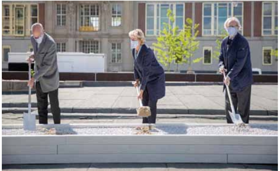
Die früheren Bundestagspräsidenten Norbert Lammert und Wolfgang Thierse (außen) sowie die damalige Kulturstaatsministerin Monika Grütters (Mitte) beim Spatenstich für den Bau des Freiheits- und Einheitsdenkmals im Mai 2020.
