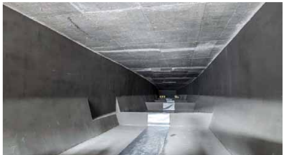
Der Eisspeicher mit 1.500 m 3 Fassungsvermögen als Saisonspeicher.
